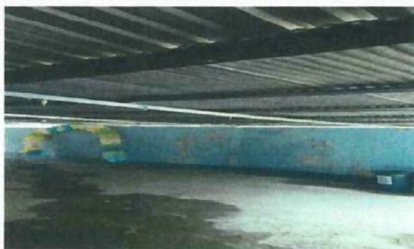
Foto 3: Levantado de entechado necesario en la cancha ya que actualmente está muy bajo provocando excesivo calor.
