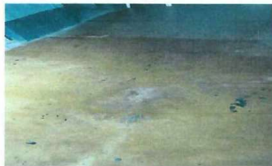
Foto 2: Hundimiento frente al baño de las niñas por posible tubería en mal estado o falla natural.
