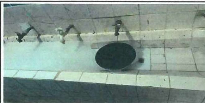
Foto 4: Obstrucción en la tubería del baño de niñas módulo 1 que ha provocado un hundimiento.
