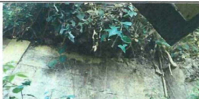
Foto 6: Reparación de 8 metros del muro de contención que se encuentra quebrado y necesita más altura en la parte de atrás contiguo al tinaco
